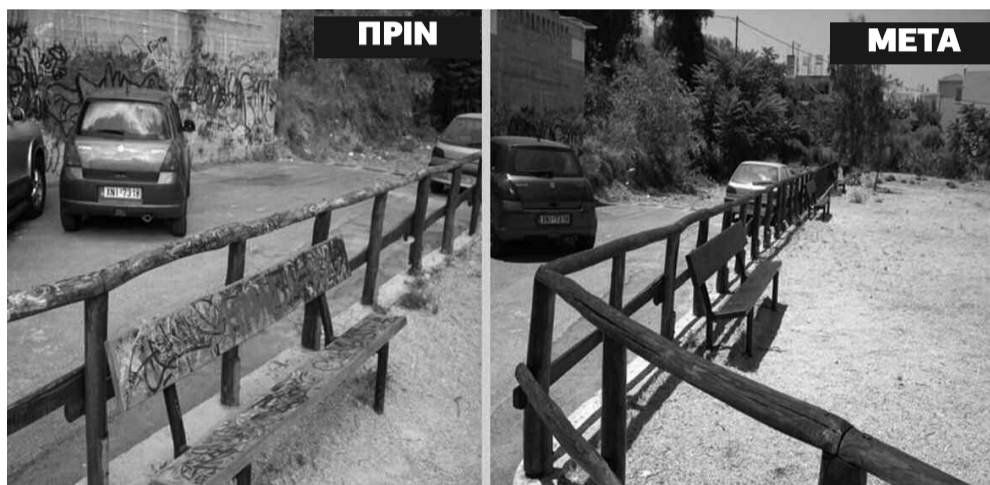
Συντήρηση και αποκατάσταση του πάρκου επί της οδού Ψηλορείτη στην περιοχή των Λενταριανών, από τα τεχνικά συνεργεία του Δήμου Χανίων.
